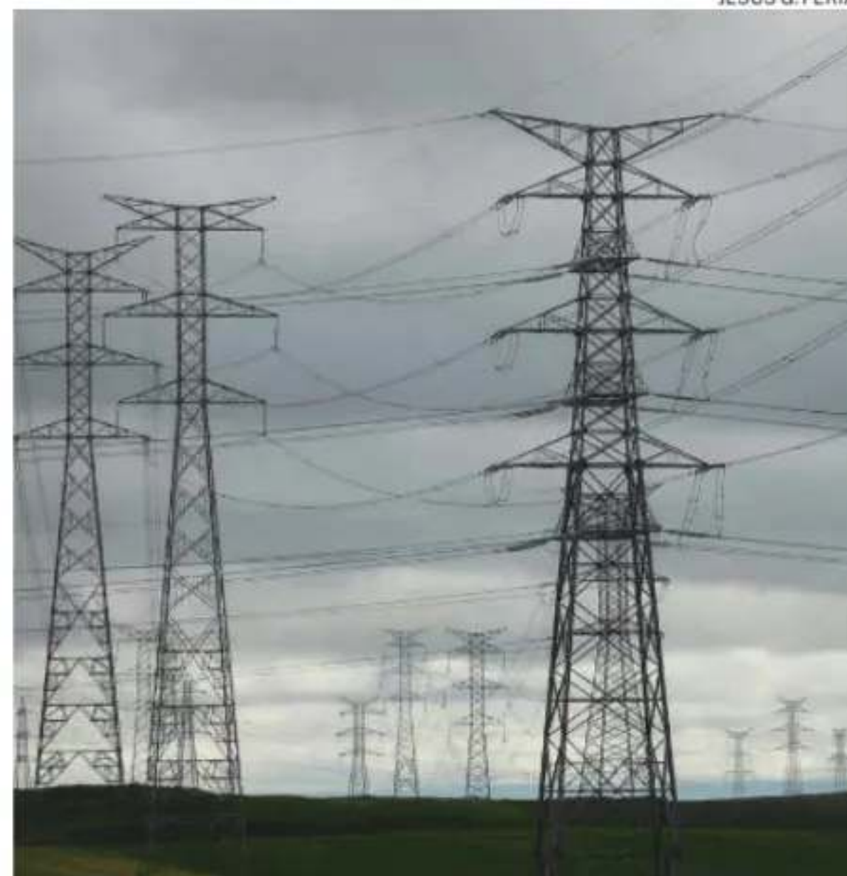
Torres de alta tensión a las afueras de Madrid
